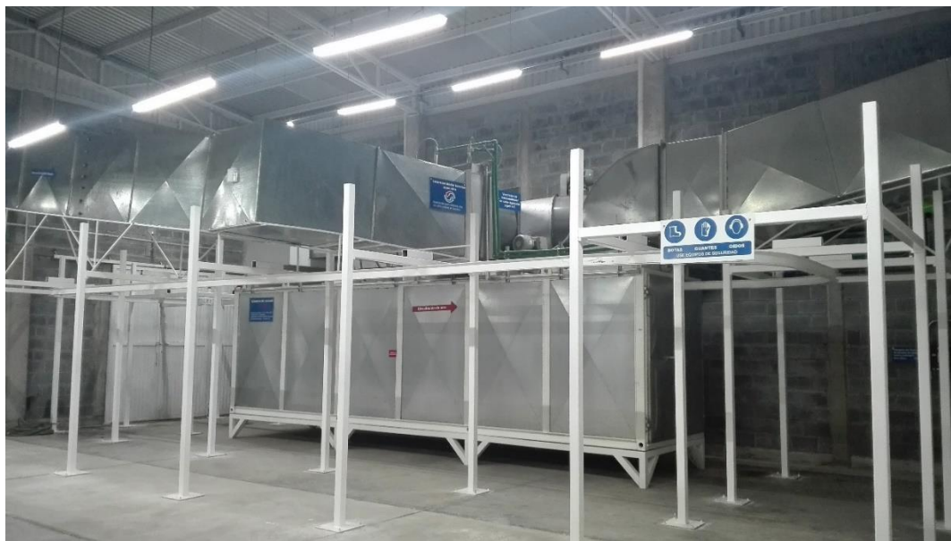
Figure 1 Cámara de secado tipo túnel semicontinuo híbrido (solar-gas LP)
