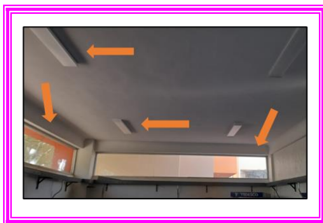
Figura 6. Iluminación del área de trabajo en la Planta Piloto de Alimentos (UASLP)
