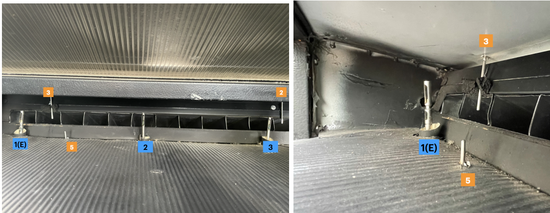
Figura 3.7: Sensores a la entrada de la cámara de secado
